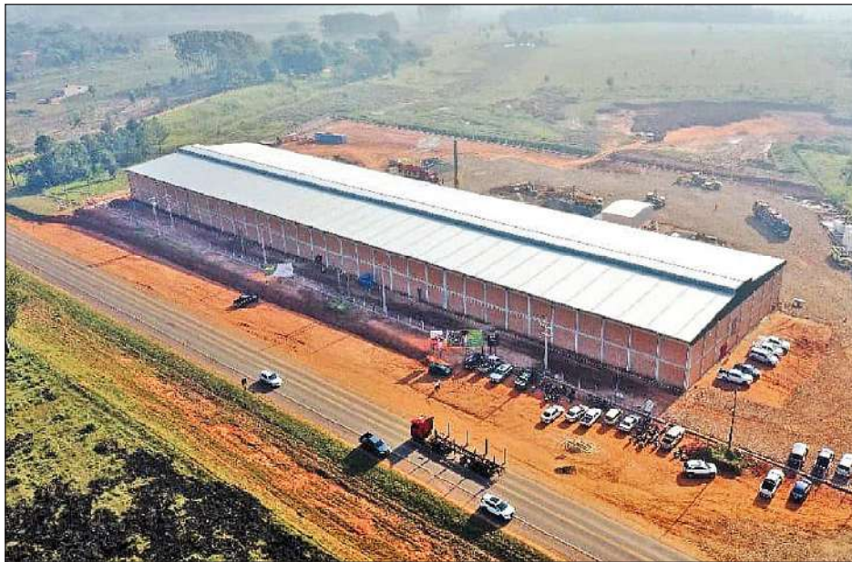
Maderera. La planta se inauguró a mediados del año pasado en Caazapá.
