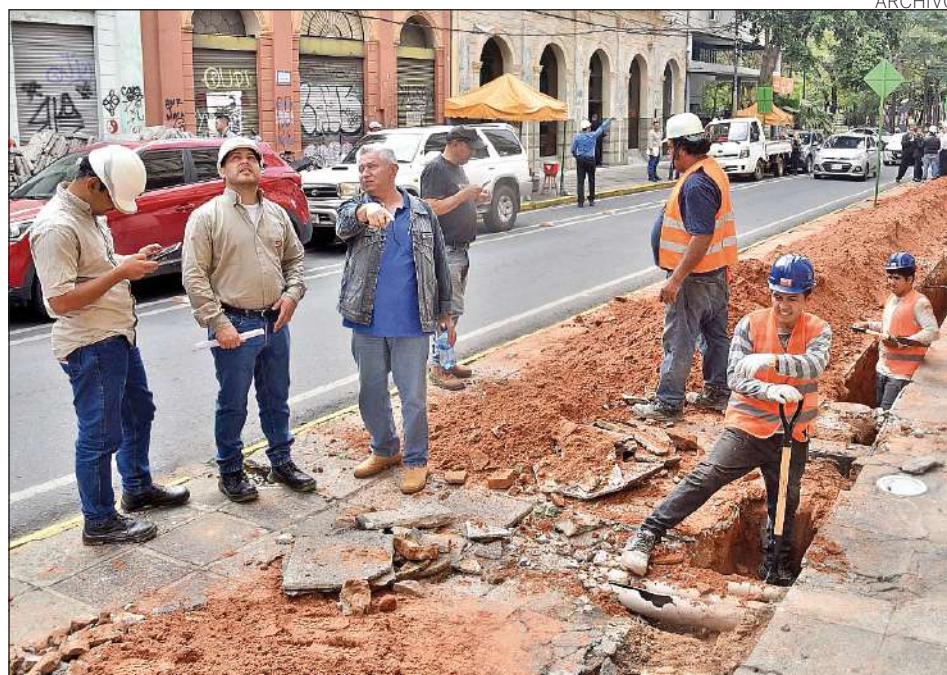
Palma Brilla. La ANDE ya realizó trabajos de cableado subterráneo en el microcentro.
