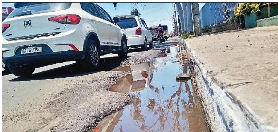
Hoyo. A pocos metros de la reciente obra de mejoramiento se observa un hondo hoyo.
