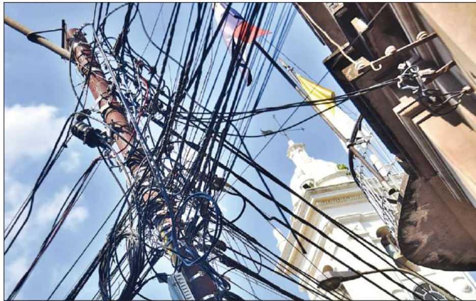
Antiguo. Muchos de los cables en la zona del microcentro se encuentran en desuso.
