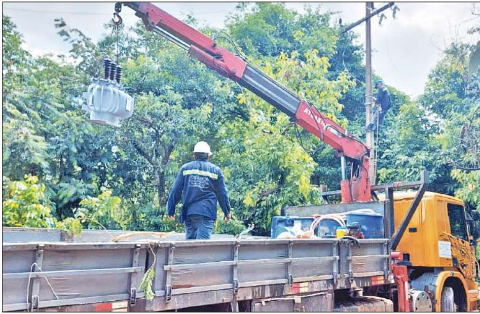
Equipos. Aquí uno de los dos transformadores con los que contaba el sitio intervenido.
