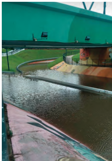
Agua acumulada en el sector del Subnivel.
