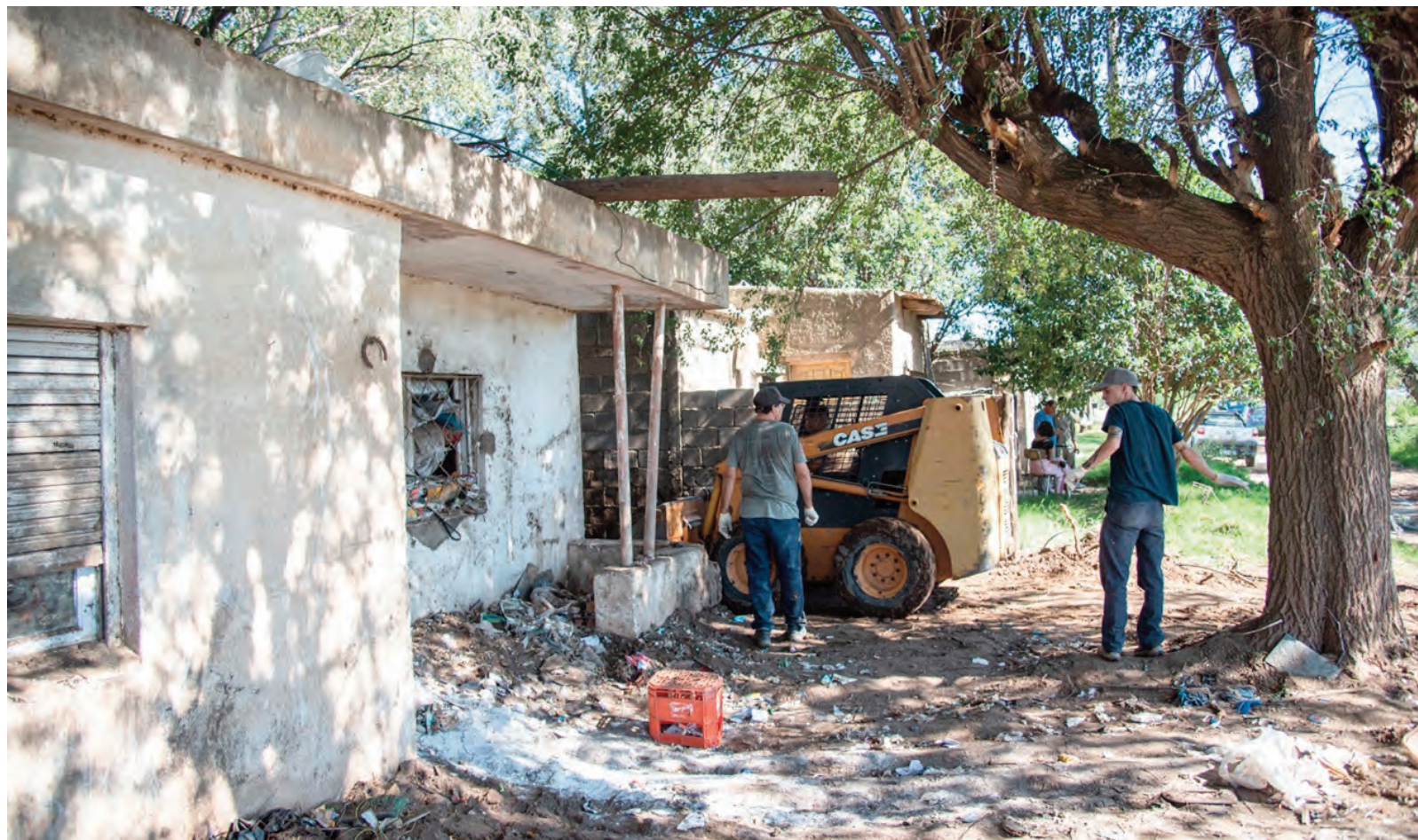
El estado de la vivienda generaba un foco de contaminación ambiental.
