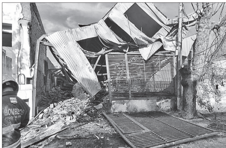
El espacio estaba subdividido con materiales altamente inflamables.
