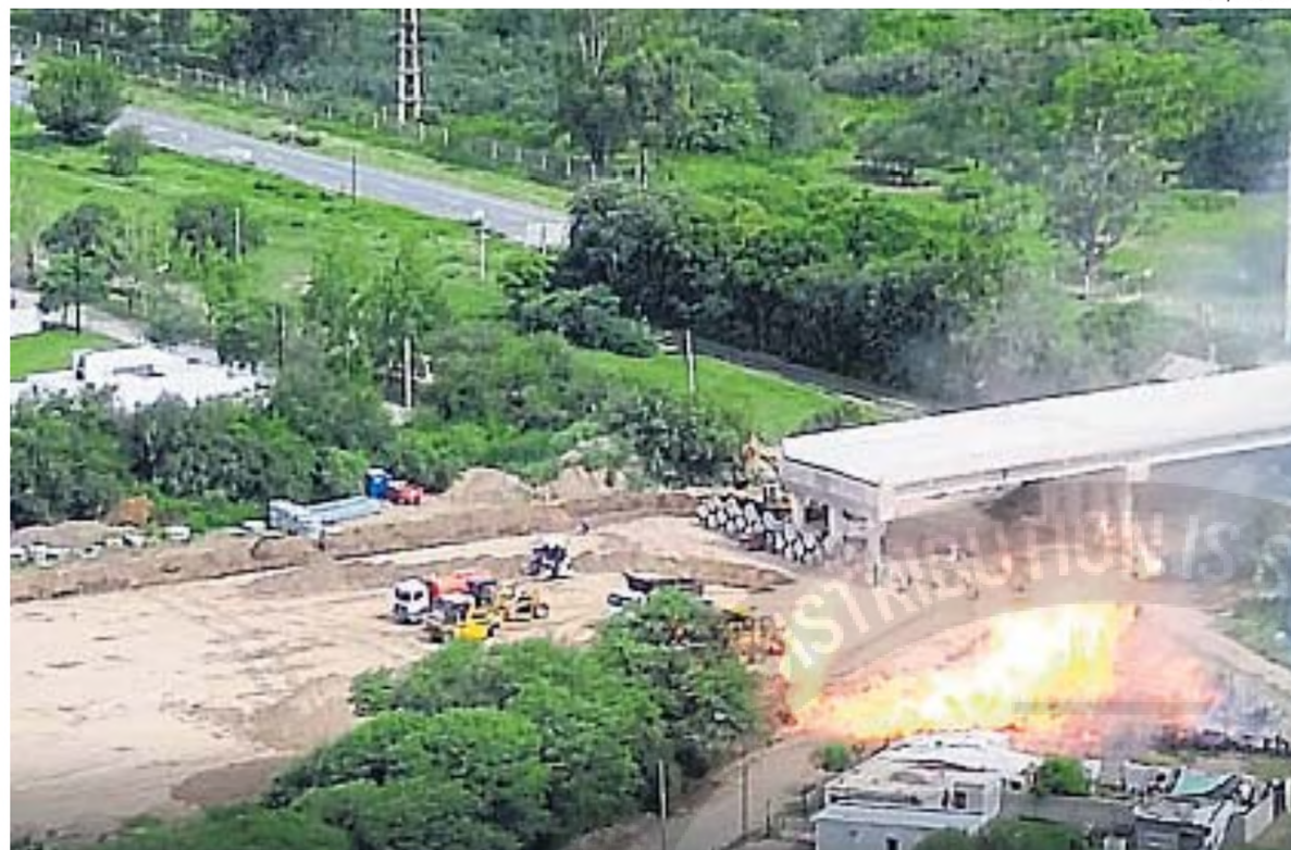
TRAGEDIA. La explosión ocurrió cuando una máquina retroexcavadora perforó un caño de gas subterráneo en Villa María.
