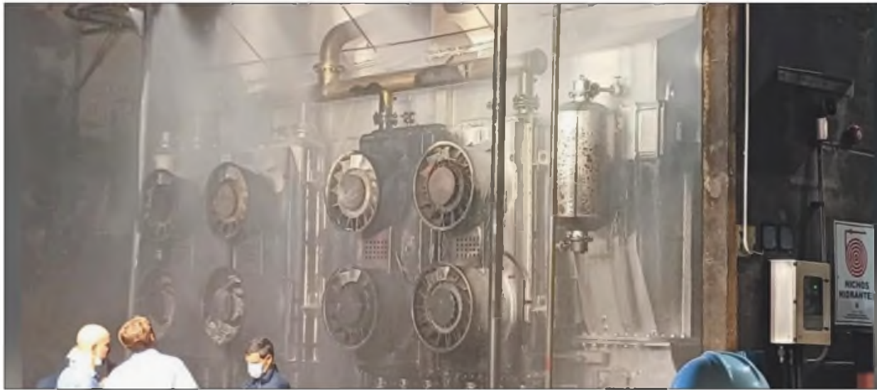
Un siniestro se registró el viernes pasado en el transformador de la Unidad Generadora n.º 12
