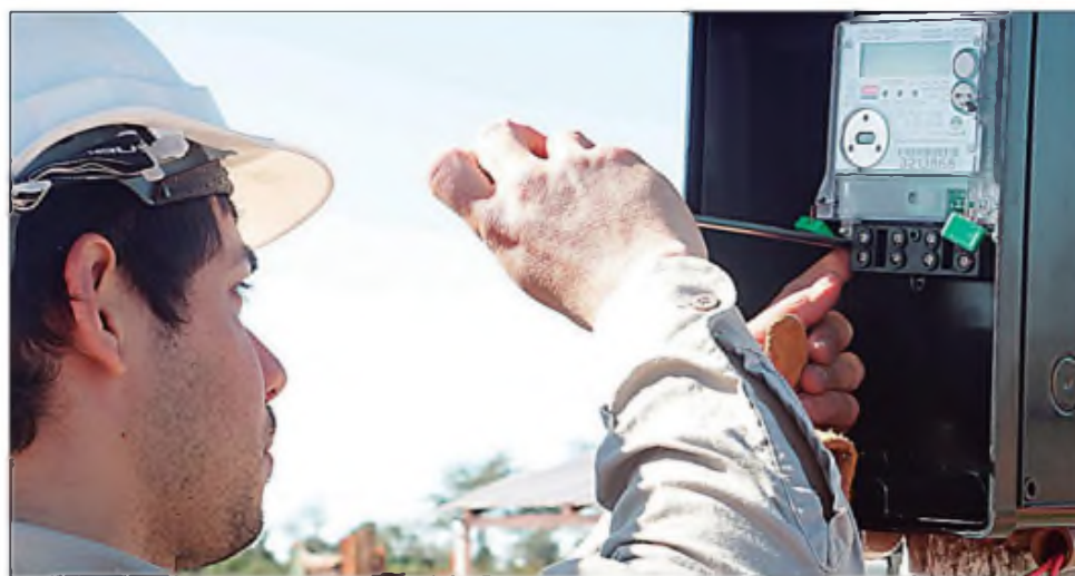
El informe de Ande revela que fueron ejecutados 1.448 cortes a suministros por falta de pago e intervenciones por conexiones clandestinas
