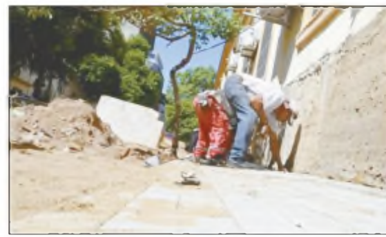
Los trabajos iniciaron en la calle Presidente Franco, entre Nuestra Señora de la Asunción y Chile
