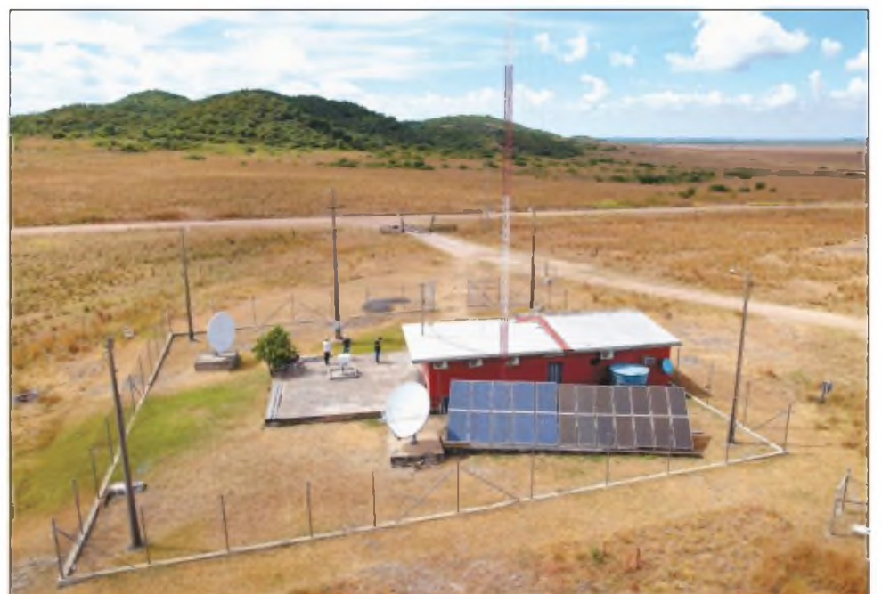
La estación cuenta con baterías y paneles solares que le permiten seguir operando en caso de que se registre un corte de energía
