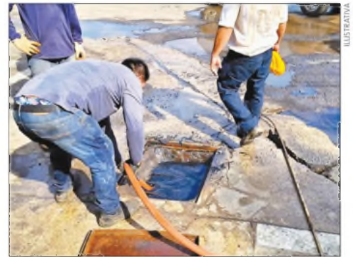
Los vecinos urgen que los obreros de la Essap pasen a reparar las averías para evitar que el agua siga fluyendo y destruyendo las calles del barrio
