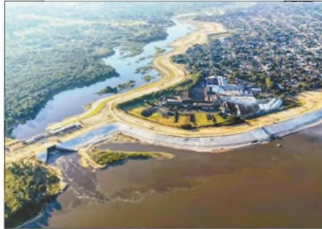
Las obras de la Fase B de la defensa costera de Pilar contemplan la construcción de un sistema integral de alcantarillado pluvial y cloacal, además de una planta de tratamiento de aguas residuales
