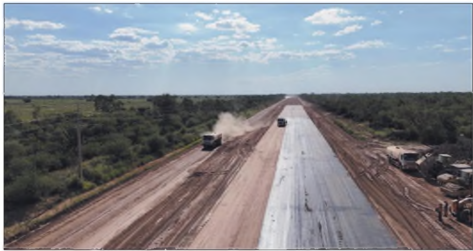
La reciente aplicación de imprimación asfáltica sobre las capas de suelo cemento en la construcción de la calzada principal, vislumbra el aspecto que tendrá la futura carretera, según MOPC
