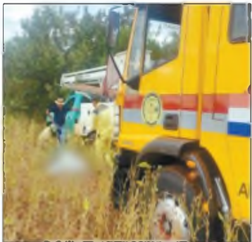
El funcionario sufrió la descarga mientras trabajaba en el poste
