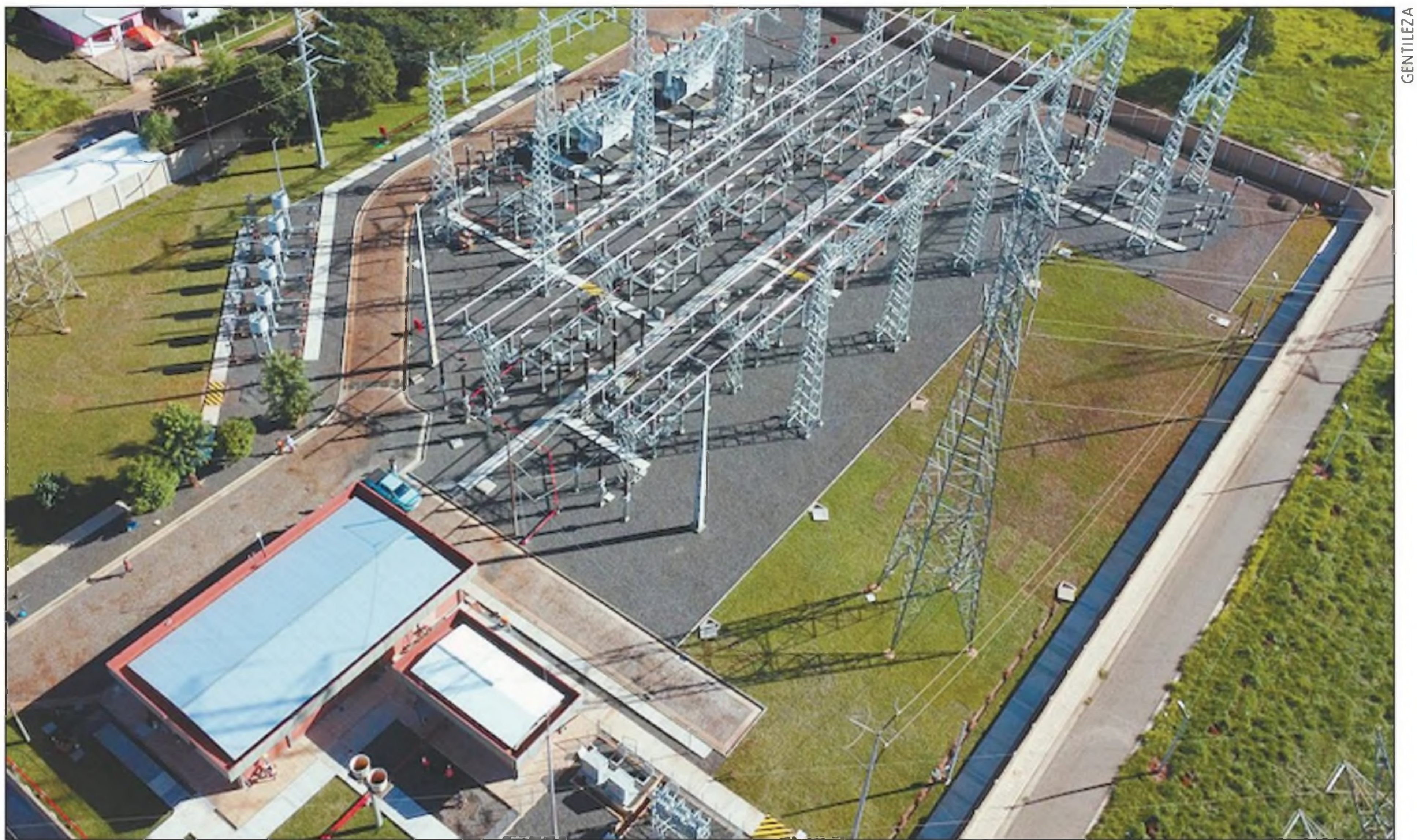
Los proyectos se dan en el marco de la planificación y ejecución de obras estratégicas requeridas para el fortalecimiento del Sistema Interconectado Nacional, contempladas en el Plan Maestro de Obras
