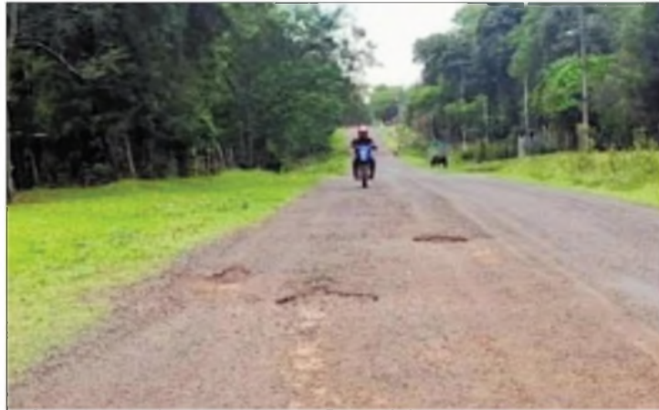
La obra vial, terminada en 2022, ya es una verdadera bomba de tiempo para los usuarios, informa un medio digital Caazapá Ahora, del citado departamento
