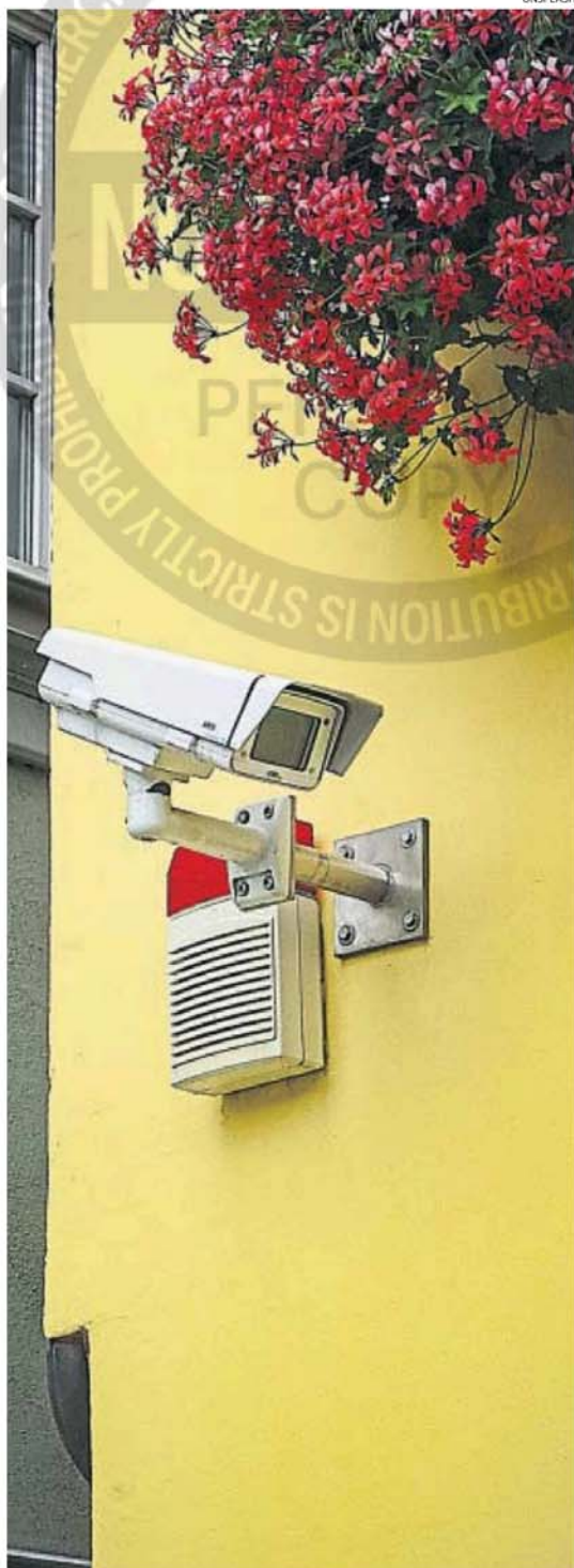
MANTENIMIENTO. La revisión del funcionamiento implica chequear las baterías de los cercos y sensores junto a las lentes de las cámaras, cada 2 años.
