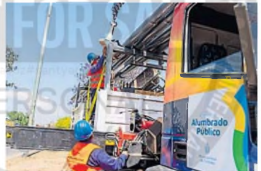
ALUMBRADO. Se subasta el mantenimiento del año junto al recambio de luces.
