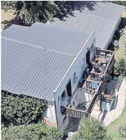
Así quedó el balcón, tras la rotura de las maderas MAURO V. RIZZI
