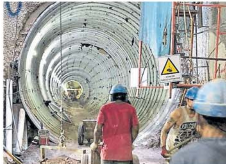
Un desagüe pluvial sin terminar, en San Isidro
