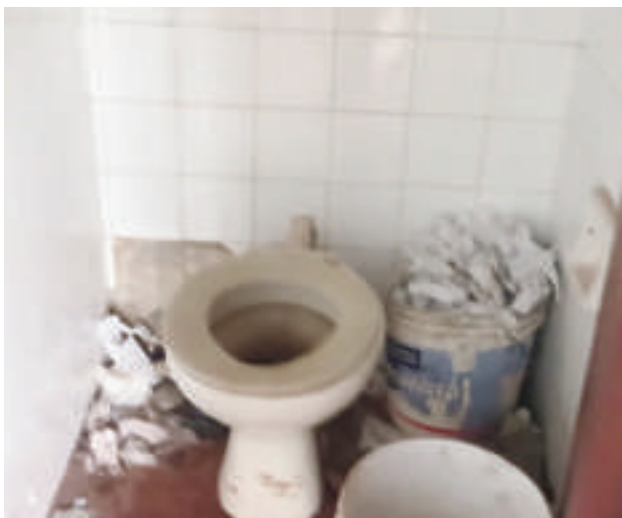
Los sanitarios de la Cancha Municipal Minga Porã están en calamitoso estado, según se puede apreciar en la gráfica.
