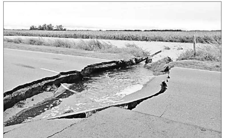
Las inundaciones provocaron cortes de ruta y hundimiento asfáltico.
