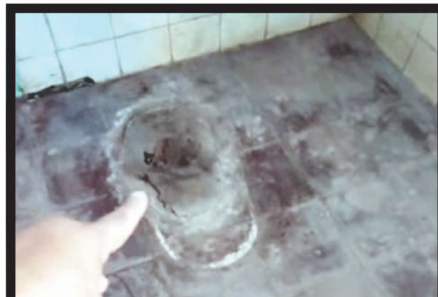
COCINA CERO En la Escuela y Colegio 8 de Diciembre de Caacupé no cuentan con cocina donde preparar los alimentos de los chicos. Por eso improvisaron un antiguo baño, donde incluso se pueden ver los rastros del inodoro. "Es insalubre y asqueroso", dijo una mamá.
