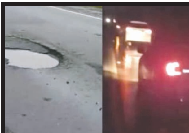
MAS DE 10. Sobre la ruta que une las comunas de Paraguarí con Villarrica, vehículos llantaron a montón por culpa de un bache enorme. Un conductor afectado subió un video a sus redes quejándose del mal estado de la ruta y la nula intervención del MOPC, en repararla.
