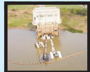
RÍO. Bajo nivel ya dificulta el bombeo.
