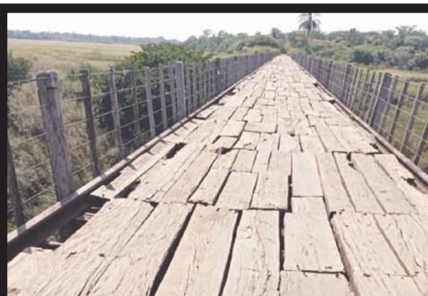
A PEDAZOS. En la ciudad de Yuty, denunciaron el pésimo estado en el que se encuentra el precario puente Fierro Punta, que une la zona con la ciudad de Yegros. Vecinos reclaman que el puente tujakue es un peligro para ambas comunidades.
