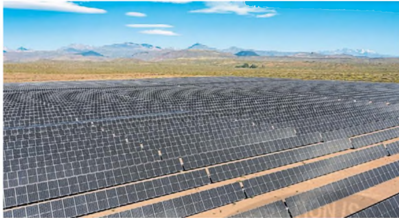
Parque solar. Se extiende sobre 312 hectáreas e incorpora más de 160.000 paneles.
