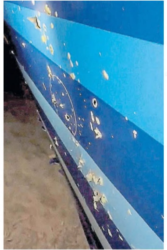
Evidencias. Los orificios que causó la metralla lanzada por el misil. RTR
