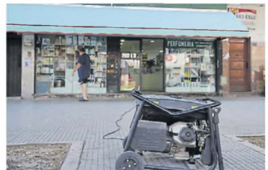
A oscuras. Un generador en la vereda, la defensa frente al corte.
