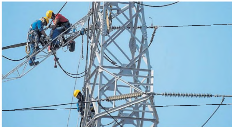
Proyecto. El tendido eléctrico de alta tensión llevará energía a lo largo de 140 kilómetros.
