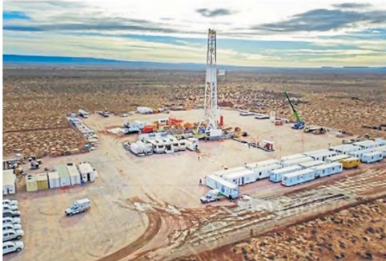
Proyecto. Tecpetrol apunta a construir otro Fortín de Piedra, pero esta vez en petróleo.
