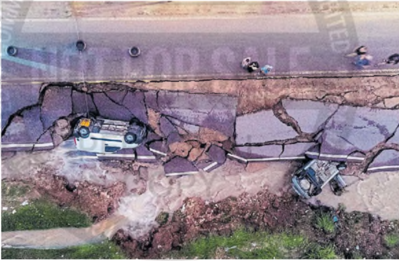
Autos "tragados". Vista aérea del pavimento quebrado en tramos de las rutas bahienses. DIEGO IZQUIERDO.
