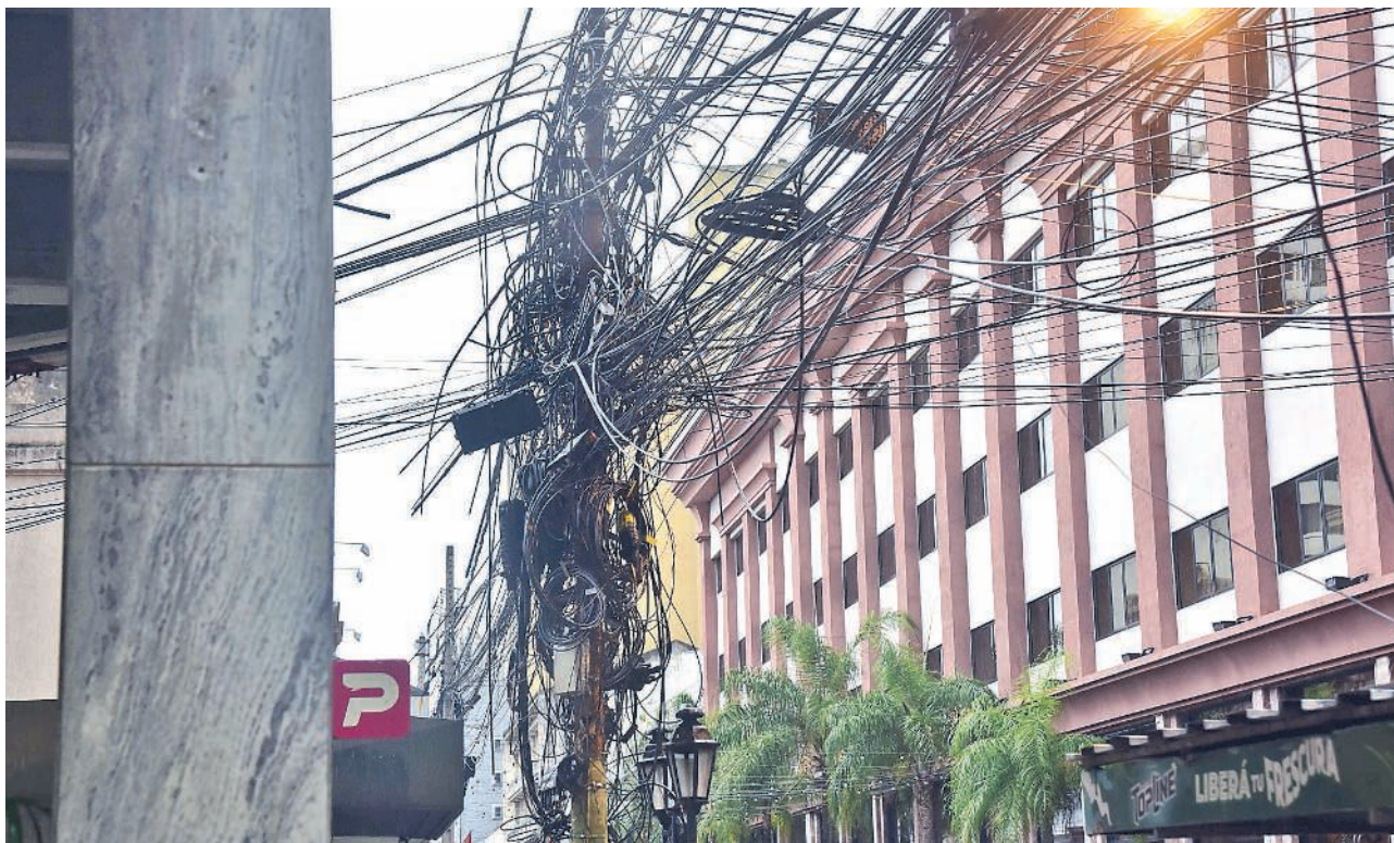
Los trabajos para el cableado subterráneo de la ANDE en varias manzanas del centro empezaron en forma simbólica.
