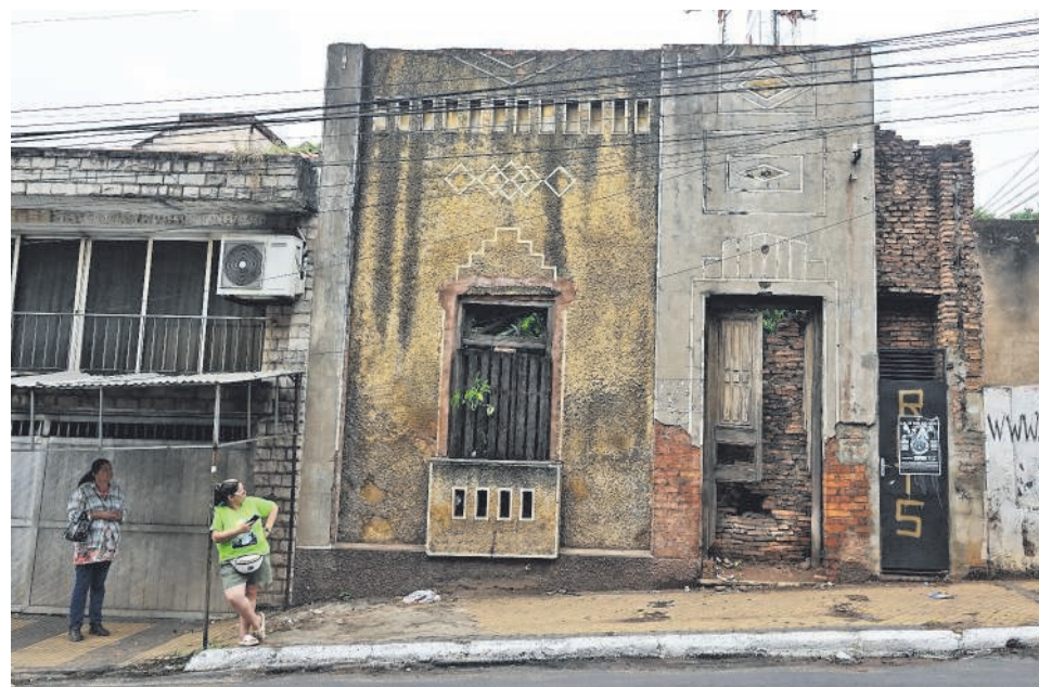
En el centro histórico de Asunción muchas viviendas se encuentran visiblemente abandonadas.
