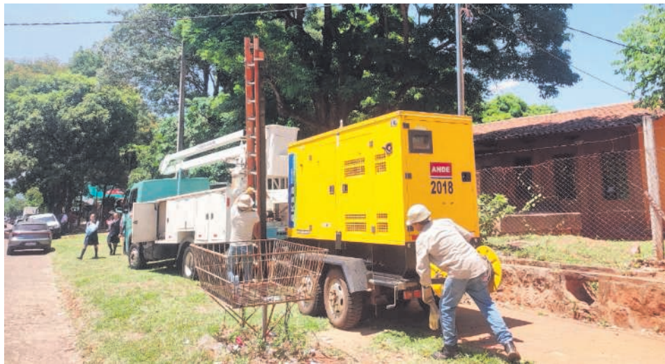
Funcionarios de la ANDE colocan un generador provisorio para que funcionen los ventiladores y evitar cortes del suministro.
