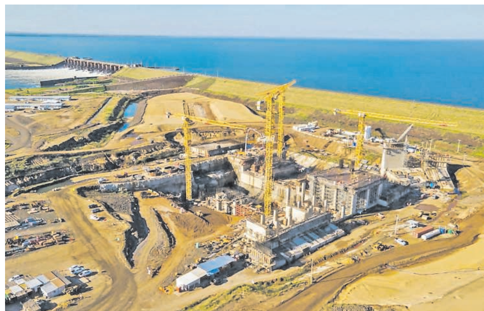
Se espera que con los recursos adicionales se puedan garantizar las obras en el brazo Aña Cua.
