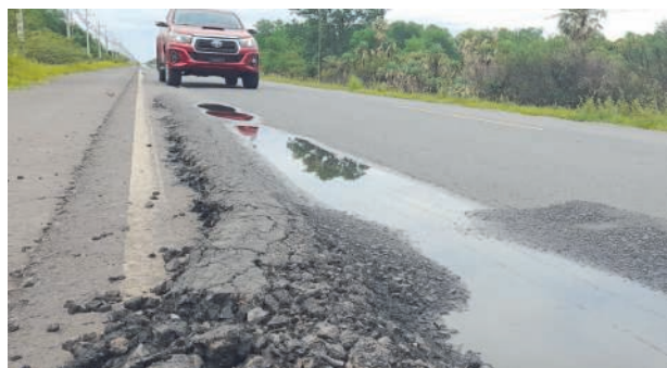
El asfaltado de la ruta PY19 está destruido en varios puntos.
