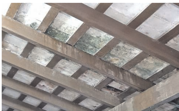
Los techos de los pabellones están visiblemente deteriorados.
