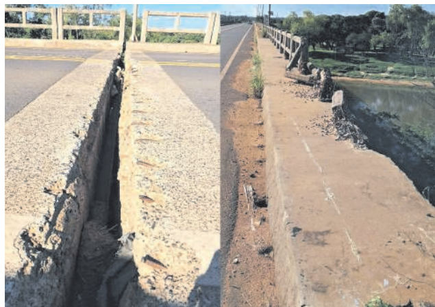
La peligrosa situación del puente sobre el Tebicuary, entre Yuty y Leandro Oviedo (PY08), preocupa a pobladores y transportistas.
