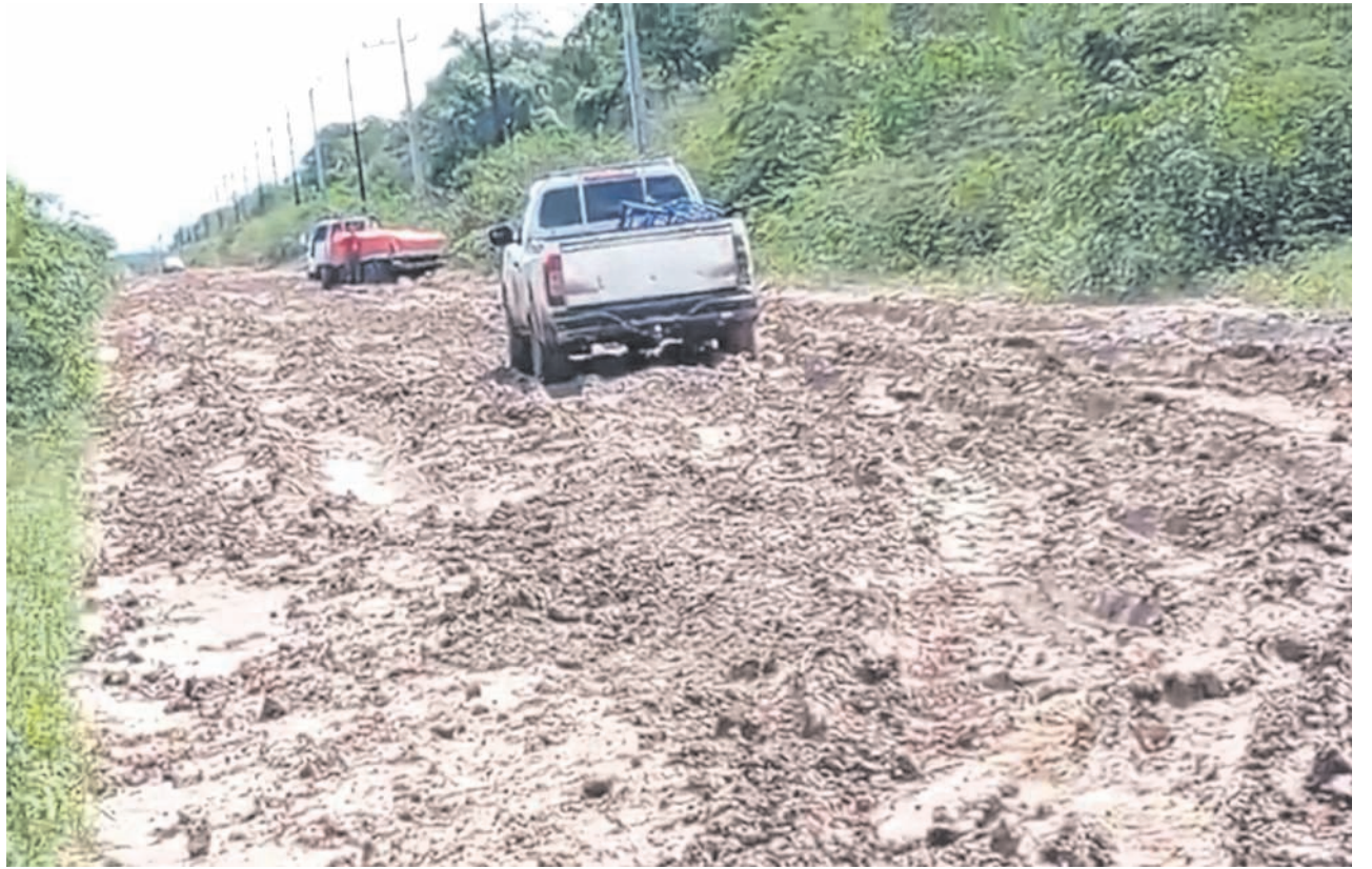
Así queda el camino que conduce a Bahía Negra luego de un aguacero. La población clama el asfaltado para salir del aislamiento.
