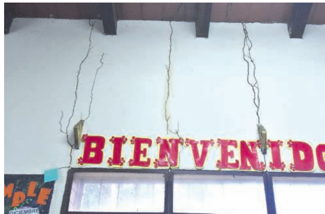
Las termitas amenazan las vigas de madera y muebles en el Centro de Primaria y Preescolar (Ceppe) de Asunción.
