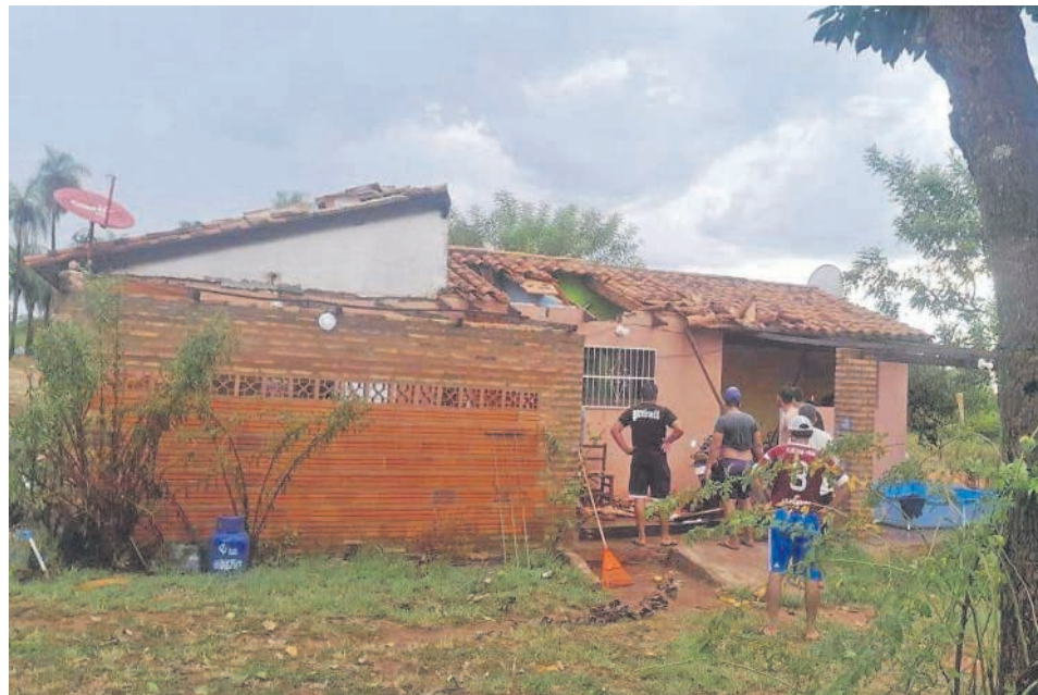
La vivienda ubicada en la compañía Comandante Peralta de Quiindy quedó dañada.
