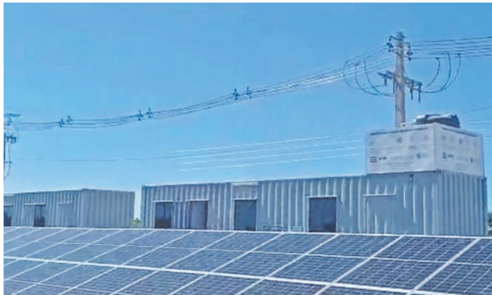
Un sector de la planta solar instalada por la ANDE en Puerto Esperanza, Alto Paraguay.
