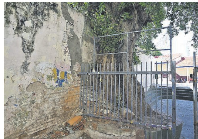
La muralla del parquecito está por derrumbarse.
