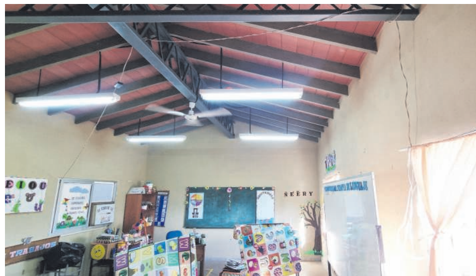
Una de las aulas con conexión eléctrica precaria, ya que se apela al uso de prolongador.
