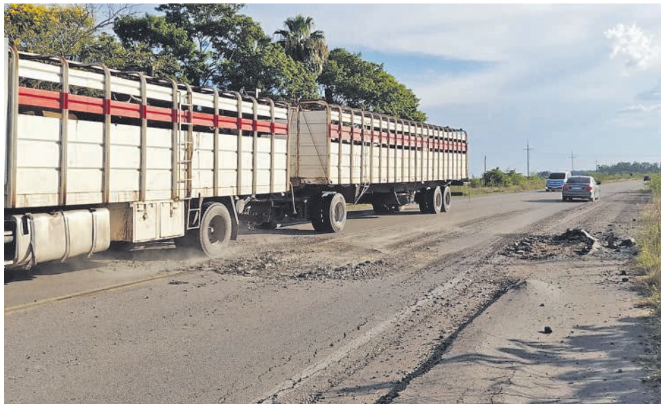
En diversos puntos de la ruta PY19 el asfaltado se está desintegrando.
