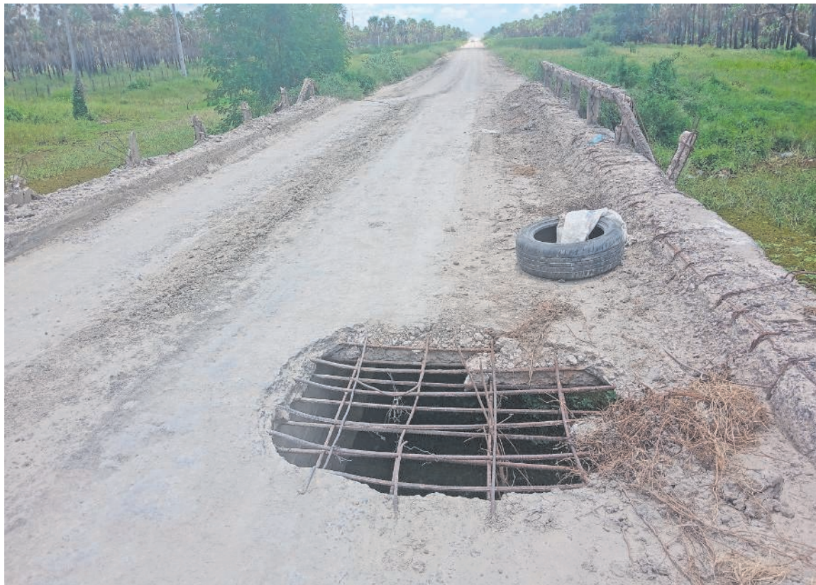
Este enorme agujero de una de las alcantarillas se localiza en el camino Fuerte Olimpo-Toro Pampa.
