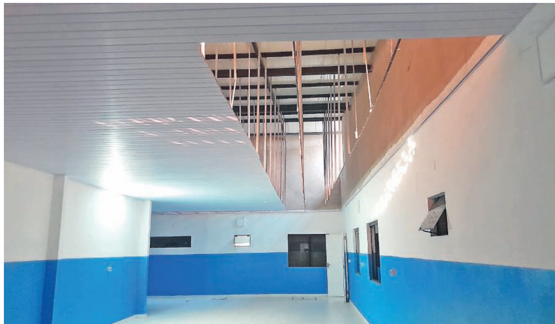
Un sector del cielo raso de la nueva infraestructura para hospital fue retirado hace unos meses debido a fallencias.
