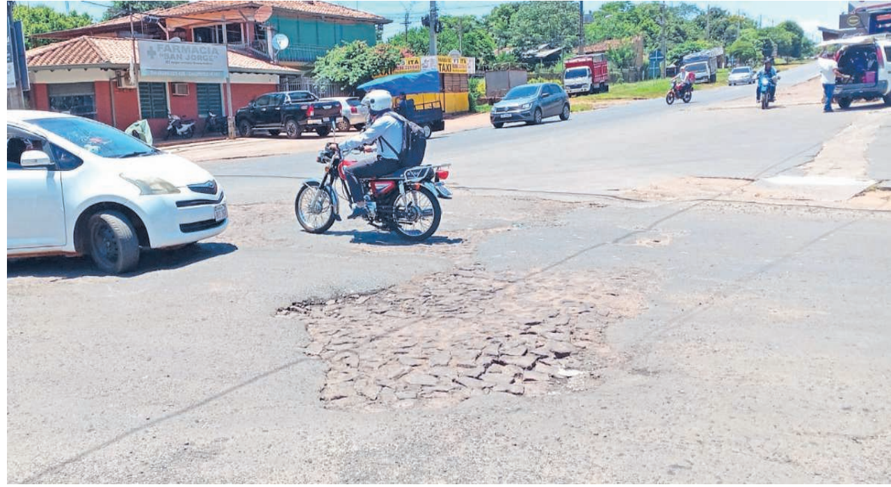
Así se encuentra la ruta D074 Gral. Marcial Samaniego. Los usuarios exigen urgentes reparaciones.
