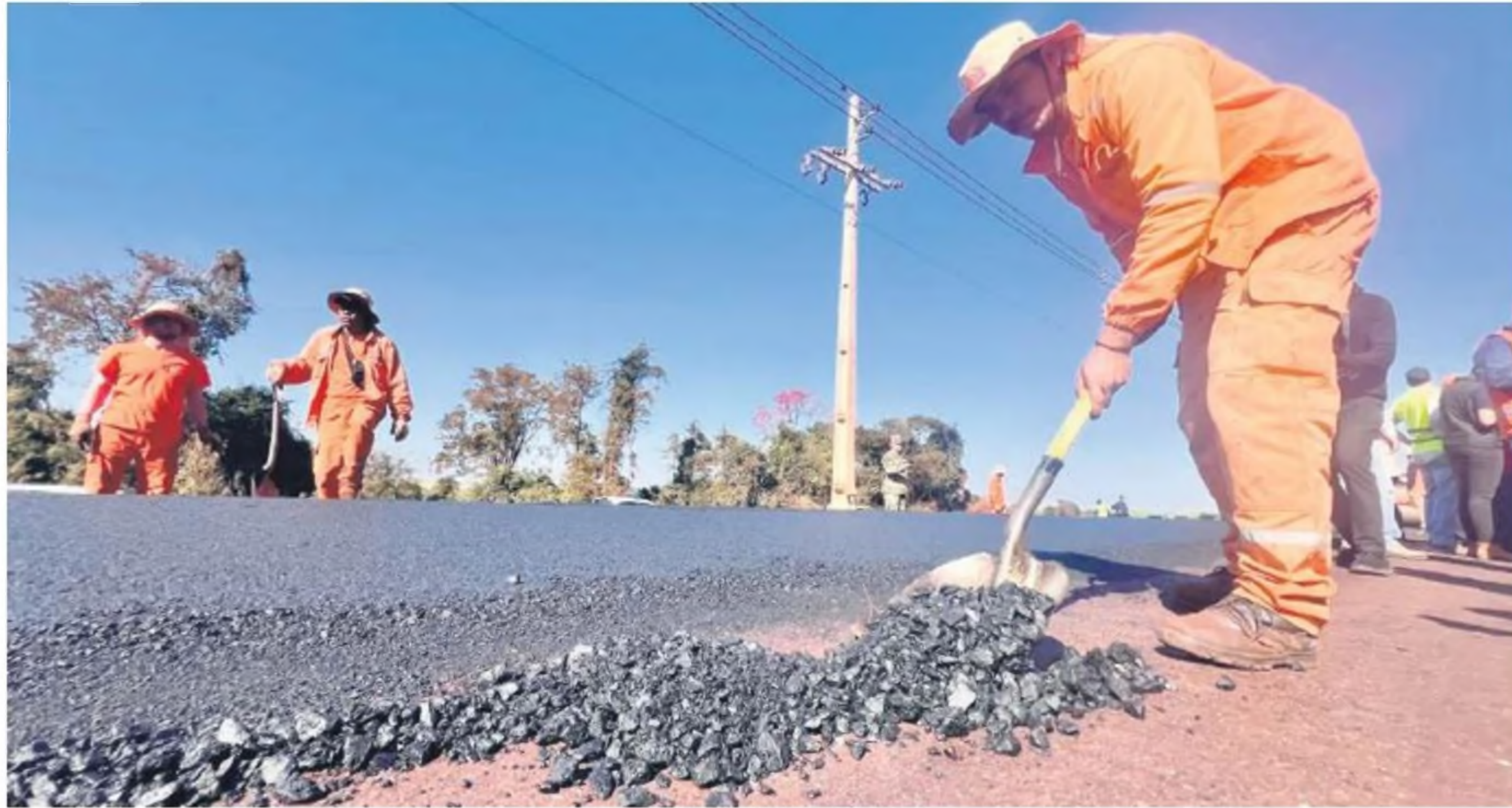
La ampliación de la Ruta PY01, es una de las grandes obras a desarrollarse vía APP.
