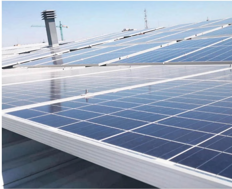
Una de las opciones de energía no convencional son los paneles solares.
